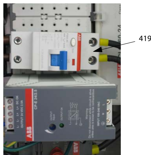
Рис. 32. Выключатель короткого замыкания на землю
